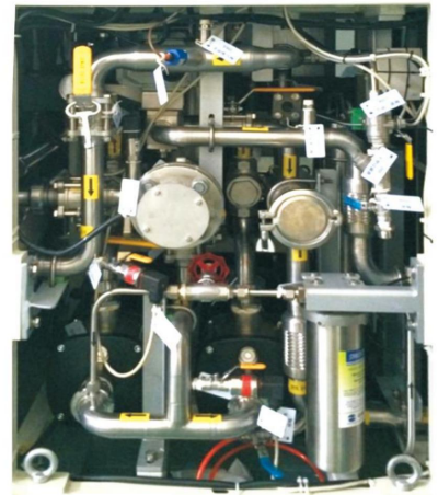
内水循环冷却系统
